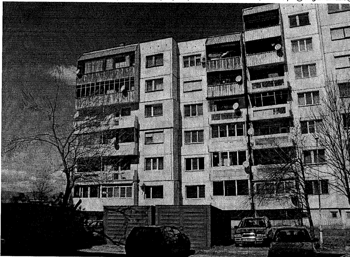
Югоизточна фасада – наличие на голям брой приобщени балкони. Частично положена топлоизолация и частично подменена дограма. Частично репарирани фуги между фасадните панели.
